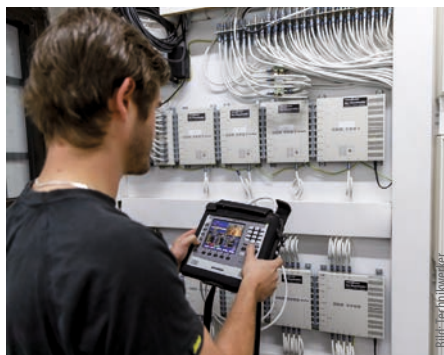
Kompetenz bei Sat- und Antennen-Installation
